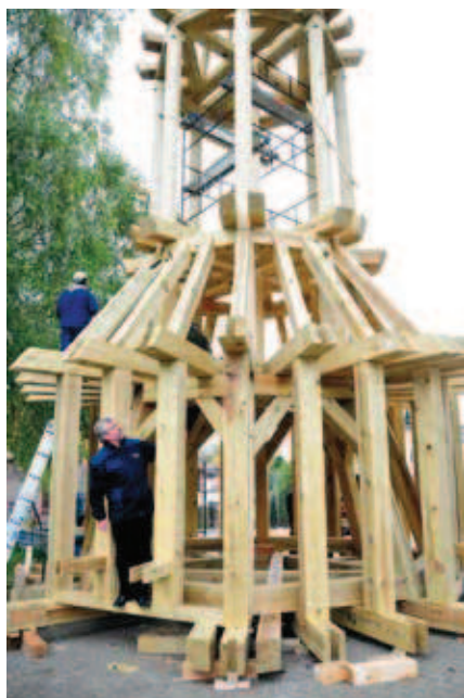
Elementy drewniane zostały połączone za pomocą gwoździ dębowych.
